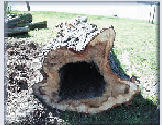
Derselbe Stamm mit der Hohlstelle im Stamminneren in Natura. Hier ist die nötige Restwandstärke für die Verkehrssicherheit eindeutig zu gering.
